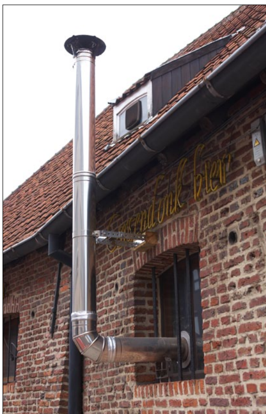
FIG. 95 Het aanbrengen van ventilatiepijpen in historische raamopeningen is geen correcte wijze van werken in een monument (copyright beeldbank Onroerend Erfgoed)
