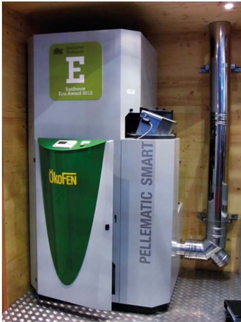
FIG. 40 Met een pelletinstallatie kan energiezuinig verwarmd worden op houtafval (foto Nathalie Vernimme)
