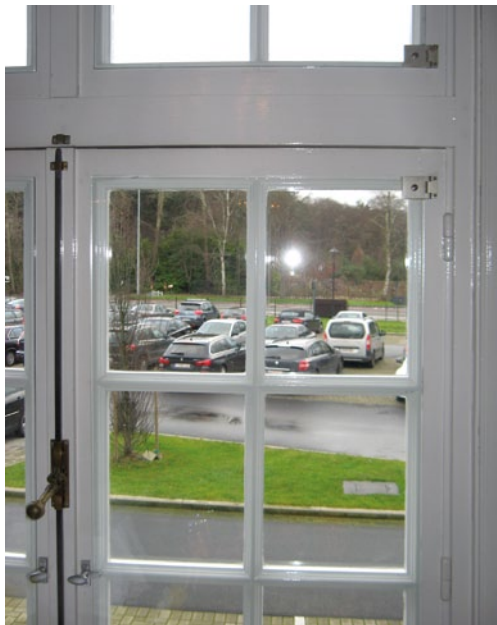
FIG. 8o Oplegbeglazing bestaande uit een kunststof plaat vastgezet met scharnieren op het bestaande schrijnwerk (foto Nathalie Vernimme)
