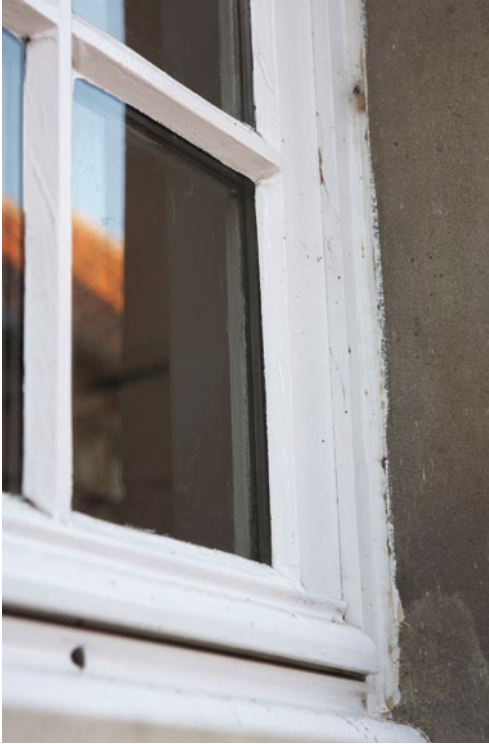
FIG. 14 Een condensgaatje in historische ramen kan helpen bij de afvoer van condens en bij het voorkomen van schimmel en houtrot van raamonderdelen (foto Kris Vandevorst)
