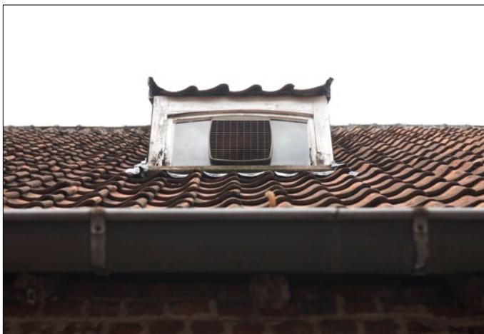
FIG. 94 Nieuwe ventilatieroosters aangebracht in het glas vormen geen goed voorbeeld van het discreet voorzien van ventilatiemogelijkheden in een historische woning (copyright beeldbank Onroerend Erfgoed)
