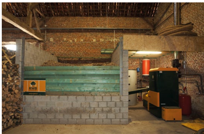
FIG. 47 Detail van de pelletinstallatie in een van de bijgebouwen van de hoeve Billighout (foto Kris Vandevorst)
