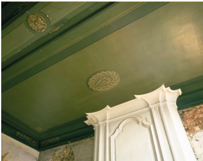
FIG. 67 Wanneer een plafond met erfgoedwaarde aanwezig is, zoals hier in huis de Clocke in Temse, kan geen plafondisolatie aangebracht worden (copyright beeldbank Onroerend Erfgoed)
