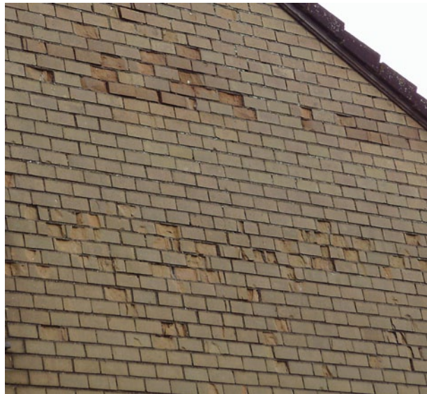
FIG. 66 Vorstschade kan makkelijk optreden wanneer binnenisolatie wordt aangebracht op een gevel met zware regenbelasting (foto Nathalie Vernimme)
