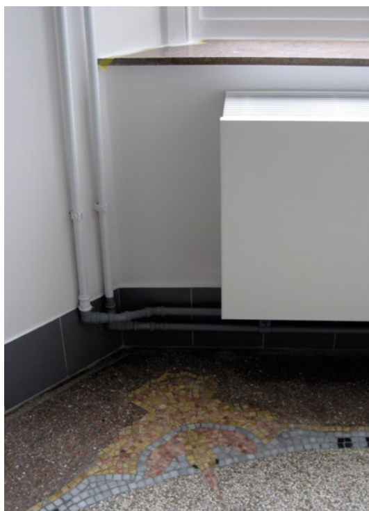
FIG. 22 Het installeren van verwarmingsbuizen in opbouw zorgt ervoor dat deze nadien ook zonder (al te) grote schade terug weggenomen kunnen worden (foto Sara Van Rompaey)
