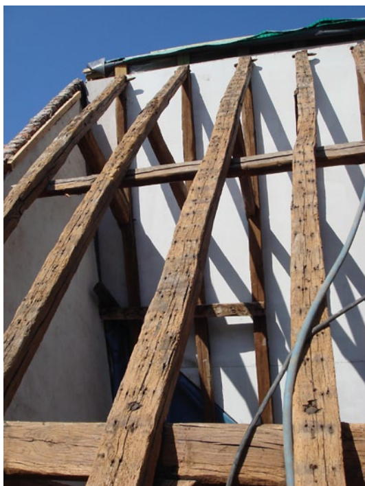
FIG. 50 Plaatsing van dakisolatie aan buitenzijde van de daksporen bij een woning in de Gouden Handstraat in Brugge. Het achterste dakvlak is geïsoleerd, het voorste wordt aangevat (foto Benoit Delaey)
