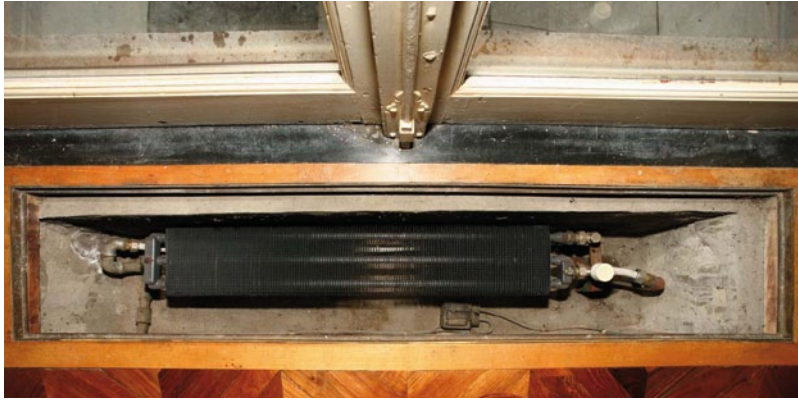
FIG. 35 Convector ingebouwd in een historisch parket en afgedekt met een rooster (copyright beeldbank Onroerend Erfgoed)
