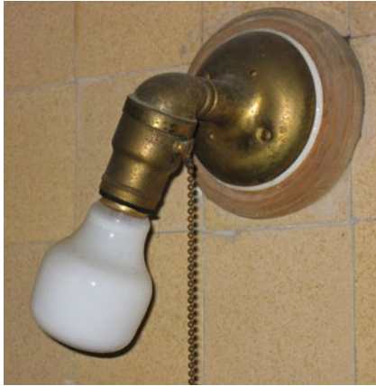
FIG. 110 Oude wandverlichtingsarmatuur in villa l'Escale in De Panne (foto Leen Meganck)
