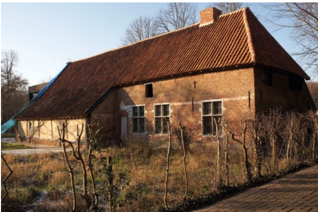
FIG. 51 Beeld van de beschermde Spikdorenhoeve in Westerlo waar een sarkingdak werd aangebracht (foto Kris Vandevorst)
