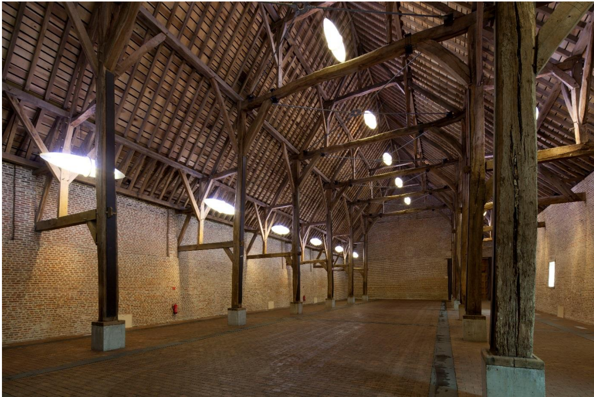
De Tiendenschuur in de abdij site Herkenrode, na restauratie. De constructie werd verstevigd en verstijfd met nieuwe stalen elementen die subtiel tussen de bestaande constructie werden aangebracht (foto O. Pauwels)
